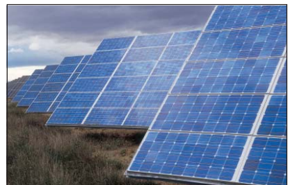
CENTRAL DE PLACAS SOLARES
